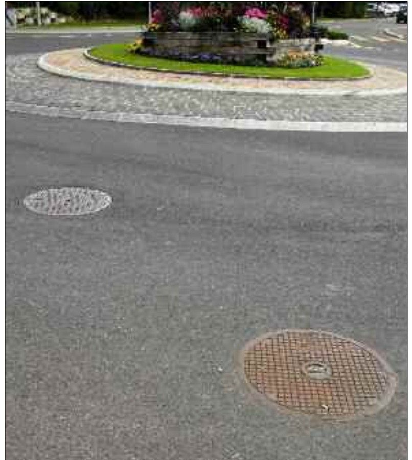
Schlecht platzierte und rutschige Schachtdeckel.
