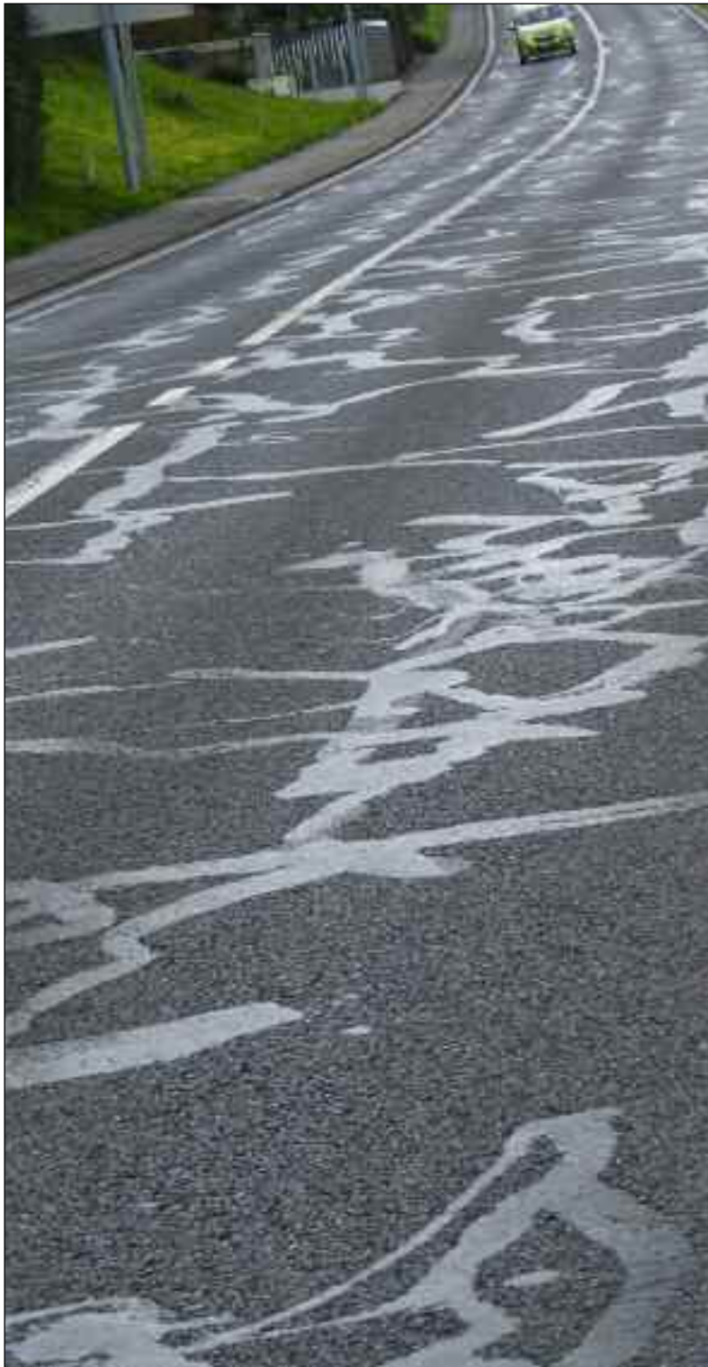
Les raccords dangereux.
